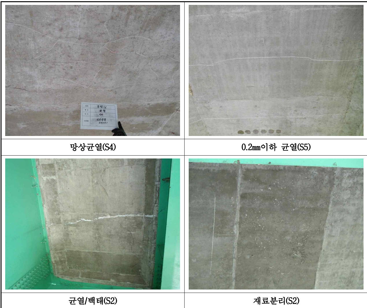
【사진 3.3.2】 바닥판 손상현황(부산)
