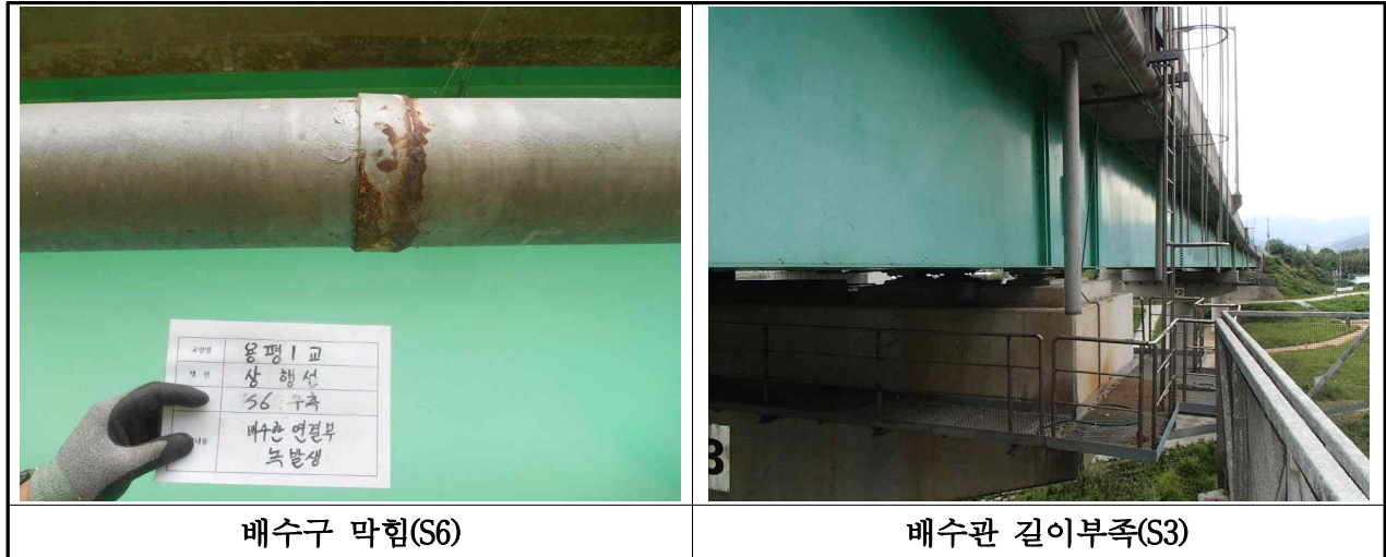
【사진 3.2.20】 배수시설 손상현황
