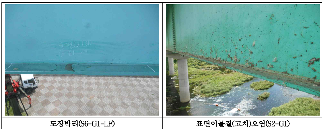
【사진 3.3.5】 강박스 거더 외부 손상현황(부산)
