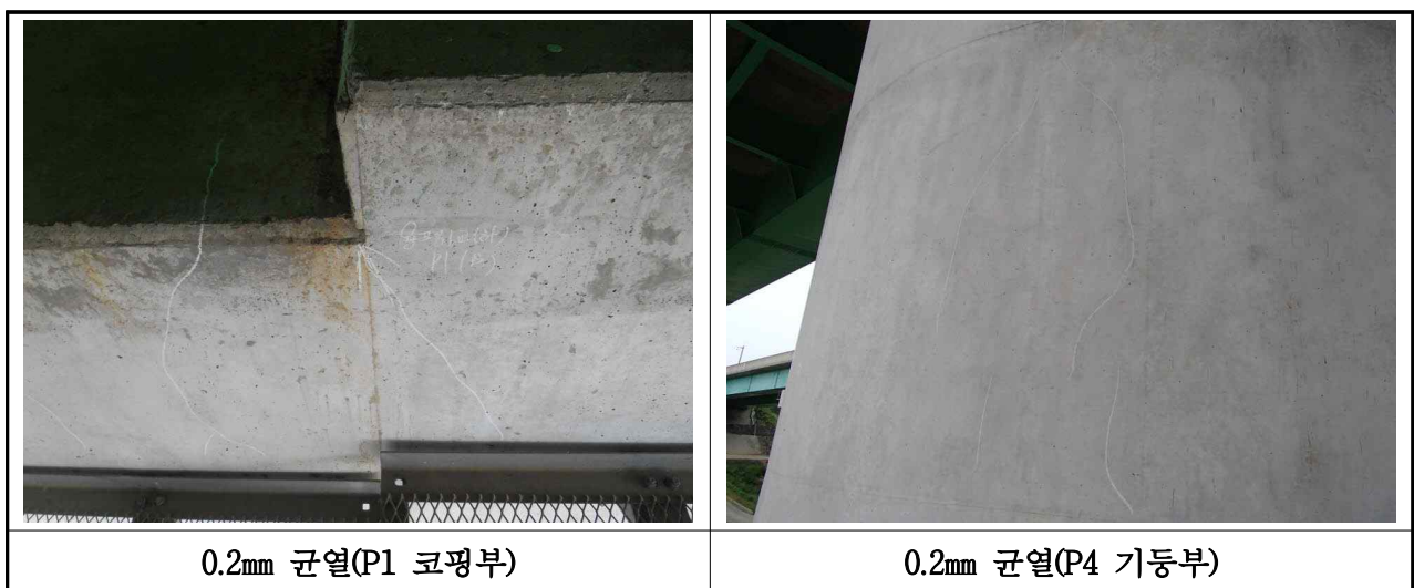
【사진 3.3.10】 교각 손상현황(부산)
