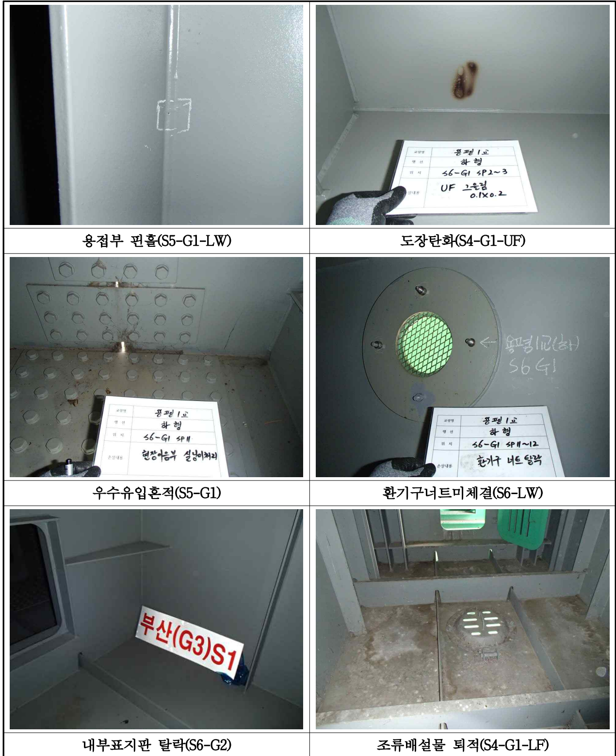
【사진 3.3.4】 강박스 거더 내부 손상현황(부산)
