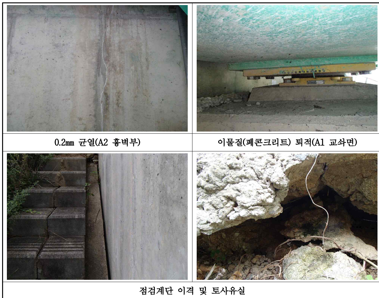
【사진 3.3.8】 교대 손상현황(부산)
