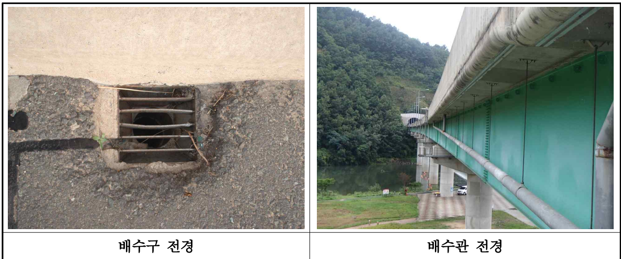
【사진 3.2.19】 배수구 및 배수관 전경(대구)
