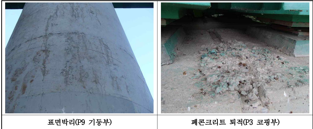
【사진 3.3.10】 교각 손상현황(부산, 계속)
