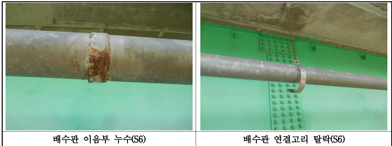
【사진 3.3.20】 배수시설 손상현황
