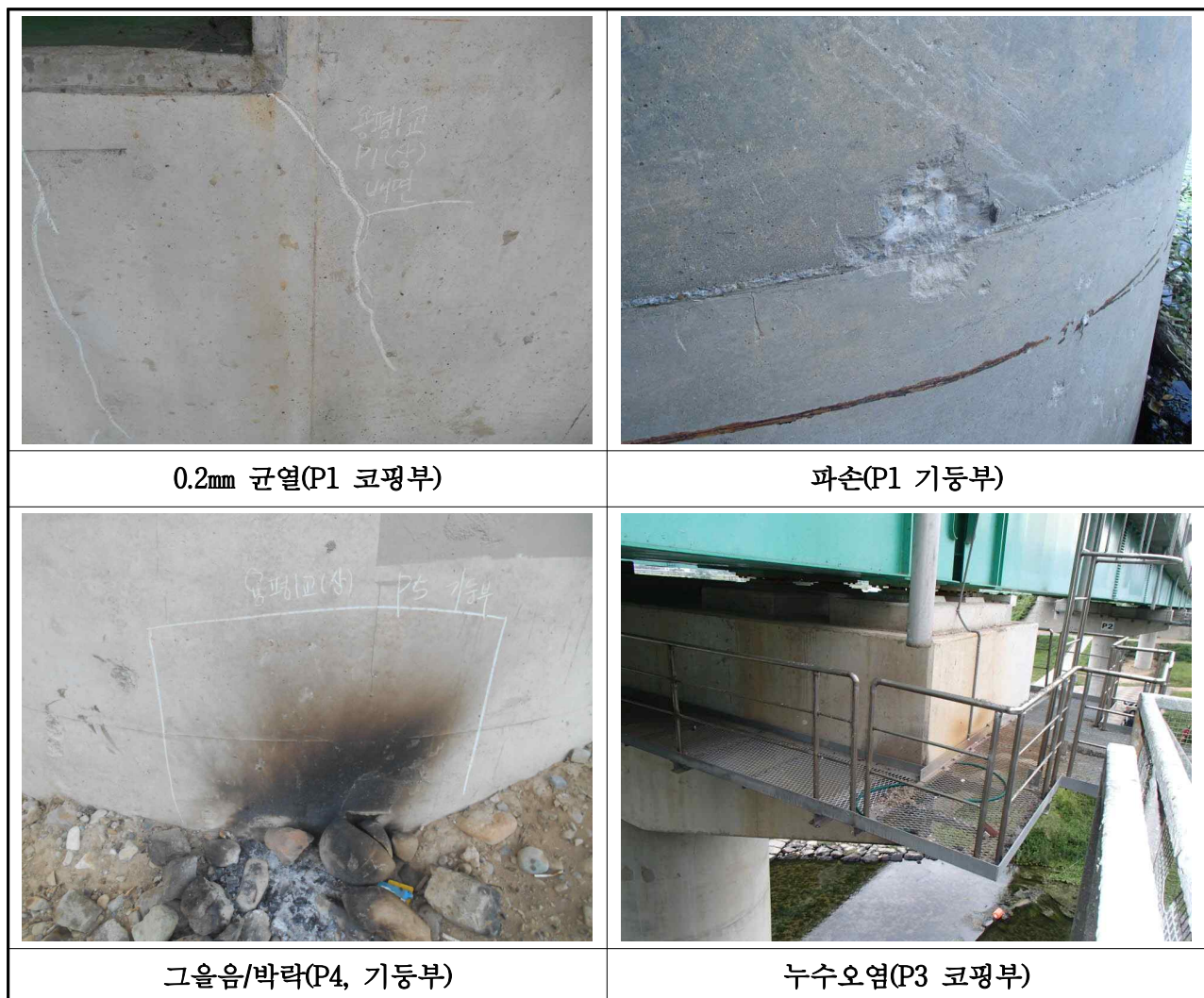
【사진 3.2.10】 교각 손상현황(대구)
