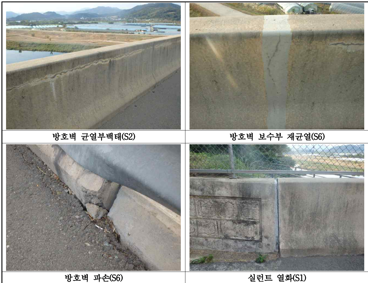
【사진 3.3.22】 방호벽 손상현황(부산)
