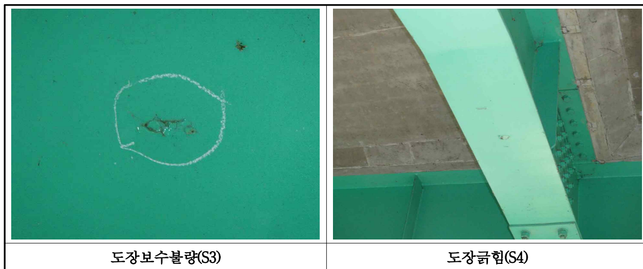
【사진 3.2.6】 가로보 및 세로보 손상현황(대구)
