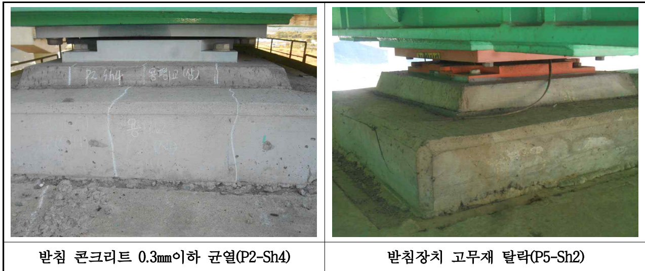
【사진 3.2.13】 교량받침 손상현황(대구)
