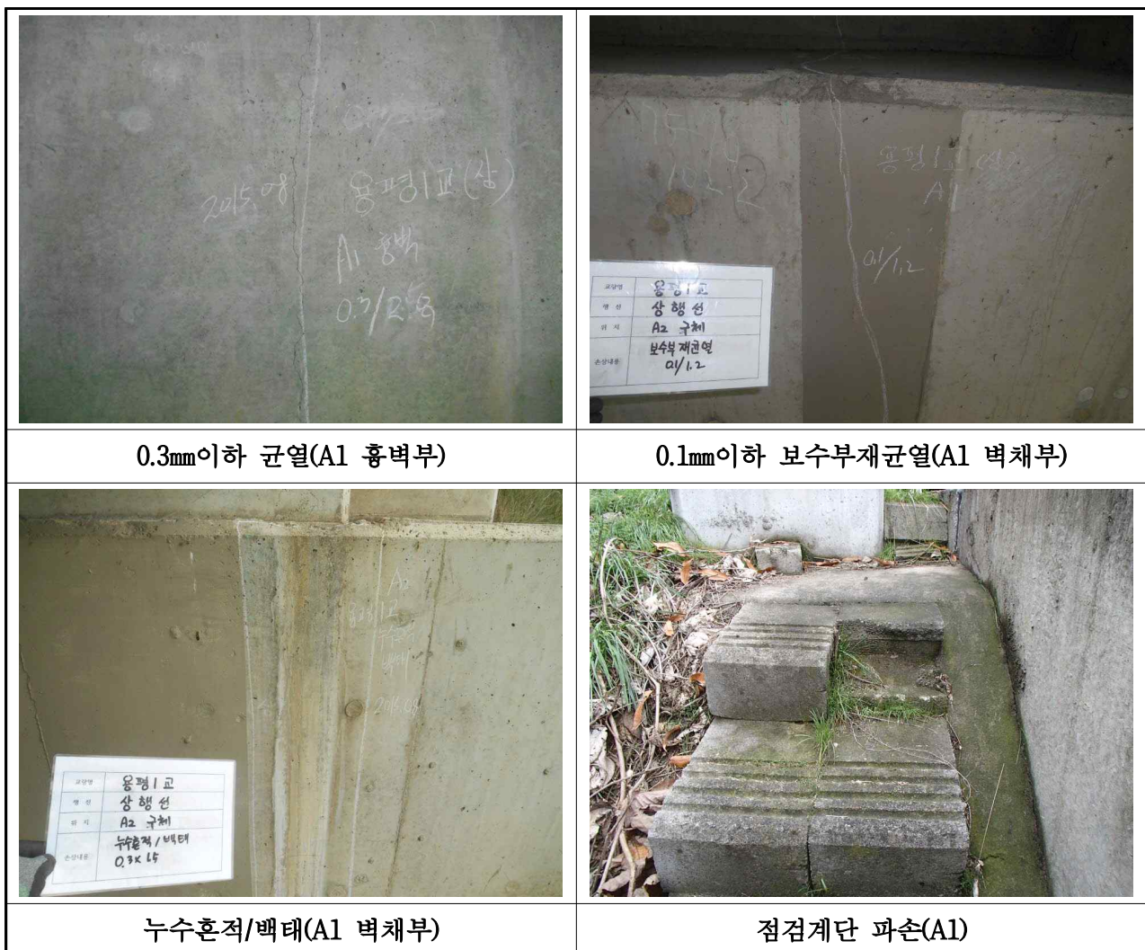
【사진 3.2.8】 교대 손상현황(대구)
